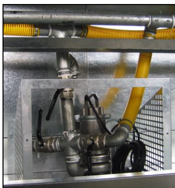
Pompe de recirculation
